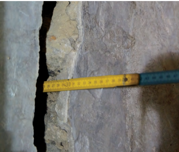
Tiefe Risse im Mauerwerk - Foto: A. Hoechel-Pradel
